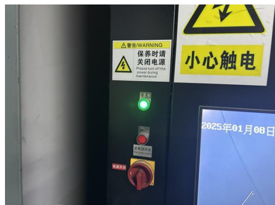
设备表面的控制按钮及急停开关
